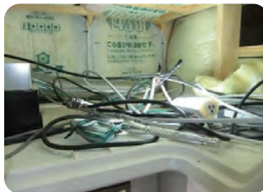
(実際の写真) 天井裏に切断された電気配線が放置されている様子
