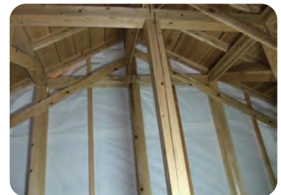
(実際の写真) 屋根裏の柱にヒビ割れが発生している様子
